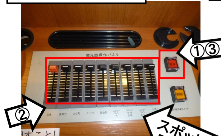
操作卓・調光器操作パネル
