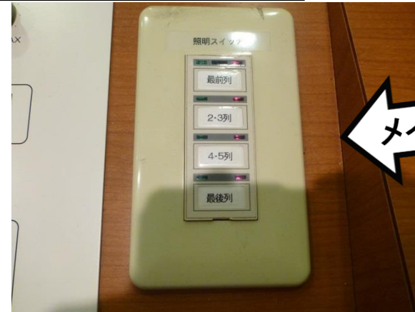
操作卓・照明スイッチ
