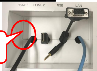
外部入力パネル
