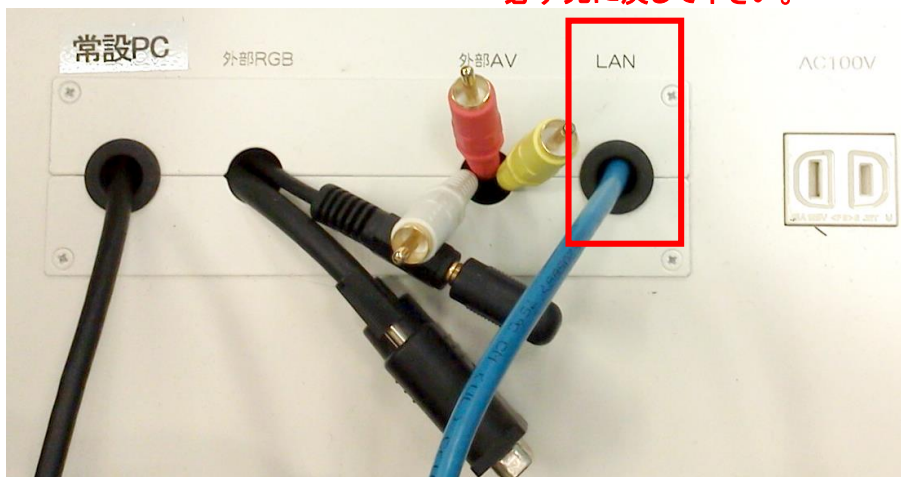
外部接続ケーブル
